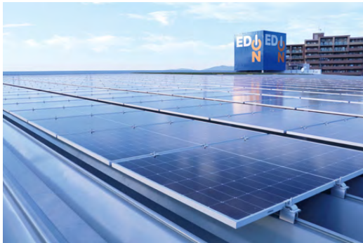
屋上に敷き詰められた太陽光パネルでの発電(交野星田店)
